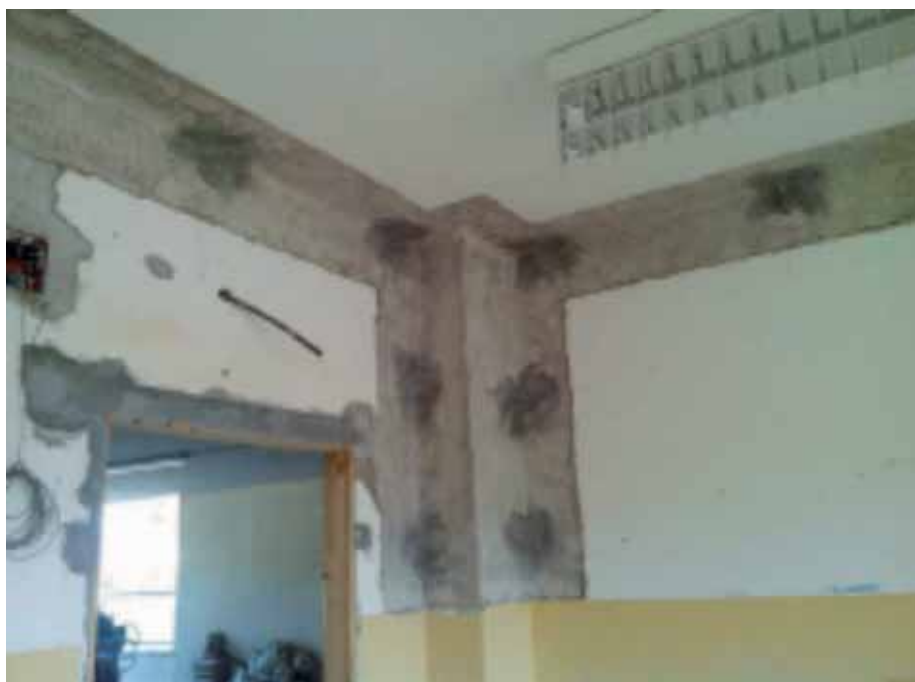
Messa in sicurezza dei tamponamenti murari con intonaci armati e connettori di ancoraggio
