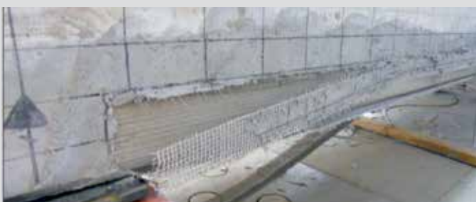
Fig. 5 Delaminazione tessuto in acciaio STEEL NET 190 allo SLU.
