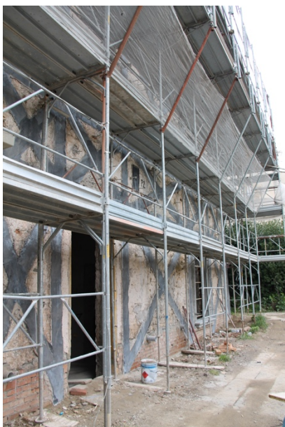
Figura 2 - Scorcio della parete esterna rinforzata
